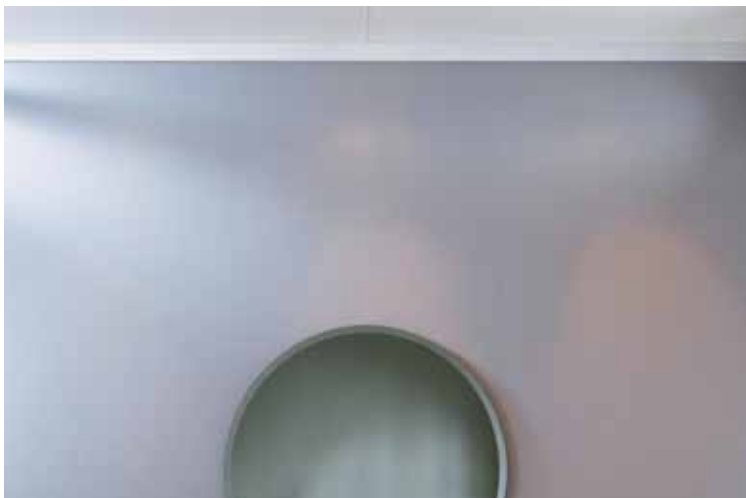
Ceiling: Huntonit Symfoni White
